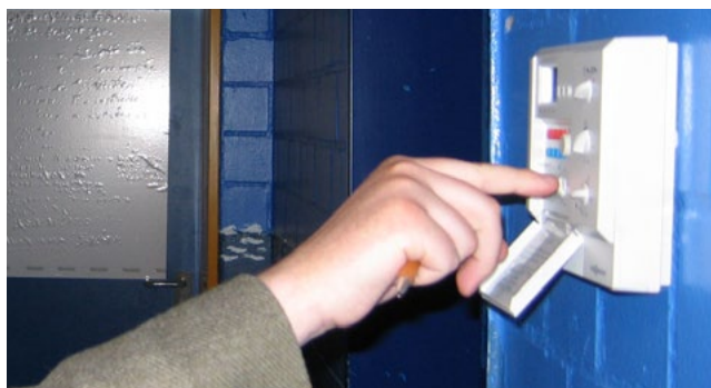
Die Einstellung der Heizzeiten ist je nach Regelungstechnik – vorsichtig gesagt – „anspruchsvoll“. Aber es lohnt sich – durch eine optimierte Einstellung der Heizzeiten lassen sich durchaus 15 % an Energie einsparen.
