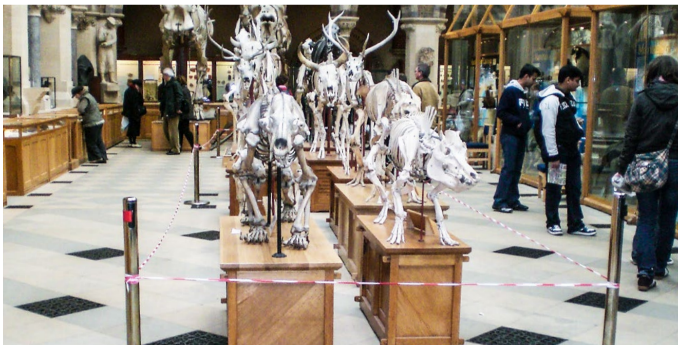
Warmluftheizungen sind prinzipiell für die Beheizung großer, historischer Räume geeignet – im Bild ein britisches Naturkundemuseum. Gut zu erkennen sind die vielen dunklen Warmluftauslässe, die in die Gestaltung des Fußbodens integriert wurden. Die Zuluftgeschwindigkeit ist so gering, dass sie von den Besuchern nicht wahrgenommen wird.
