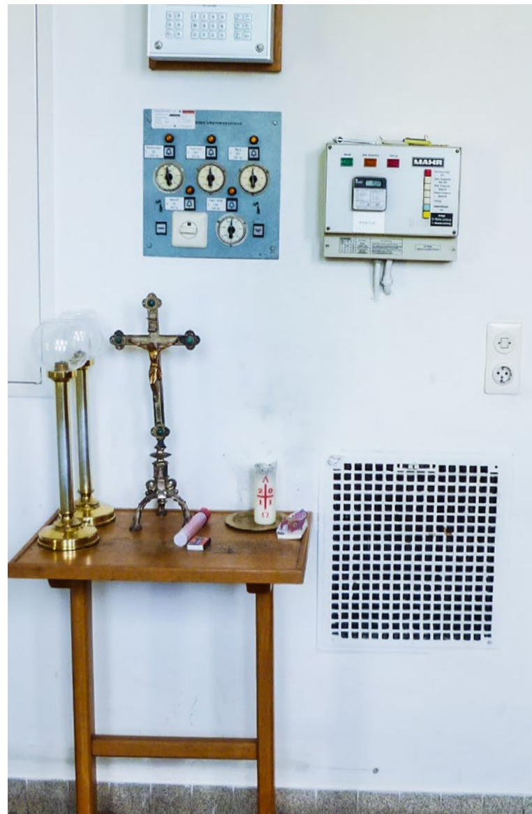
Es gibt auch Fälle, in denen die Sakristei von der Warmluftheizung der Kirche mitbeheizt wird. Damit die Sakristei genutzt werden kann, muss dann auch die Kirche beheizt werden.
